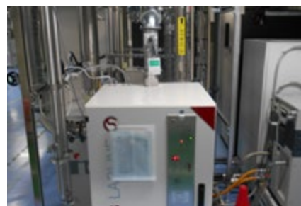
廢氣本地處理設備
