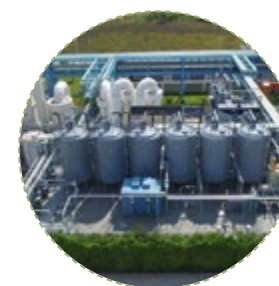
廢水回用處理設施
