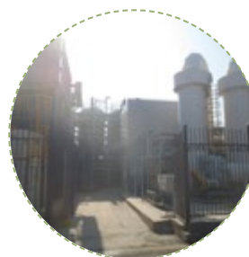
氨氮廢水處理設施
